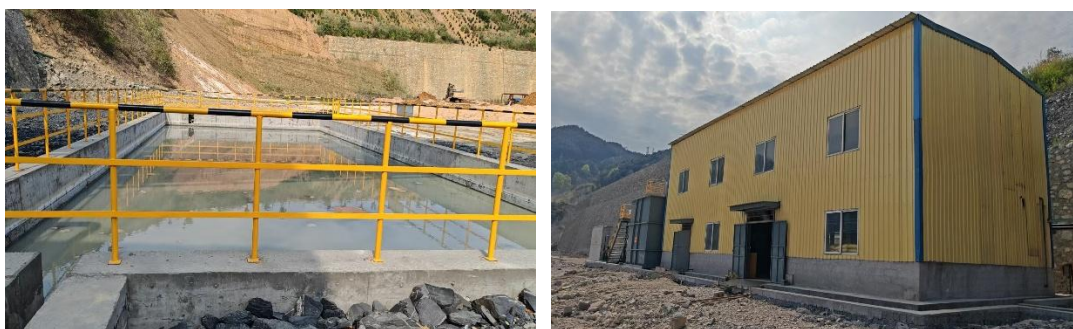
图 4.9-2 南方集团渗滤液收集池和处理站
