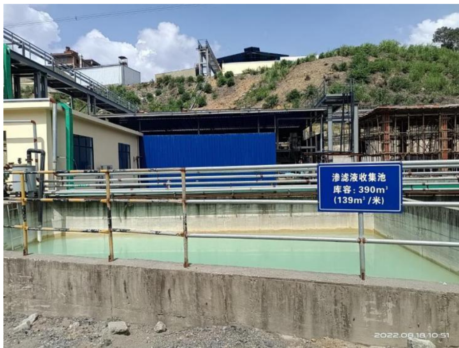
图 4.9-5 吉朗钢业渗滤液收集井和收集池
